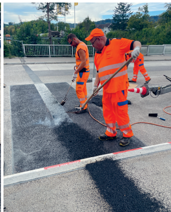
Absplittung der Oberfläche
