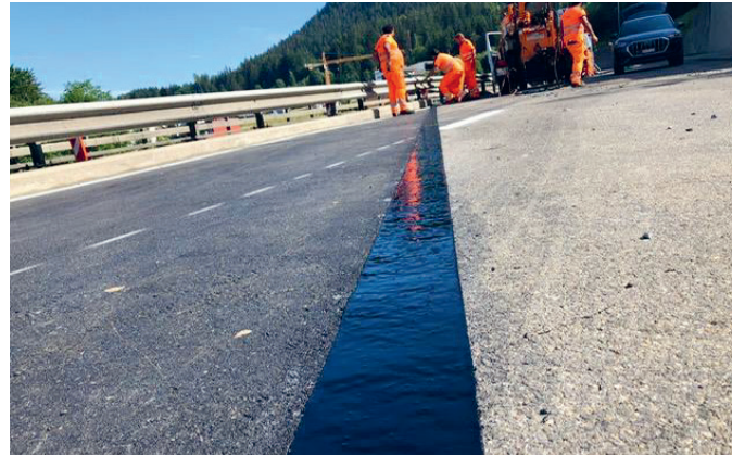
Übergang Brücke-Fahrbahn, Thorma-Flex-Fuge vor Absplittung
